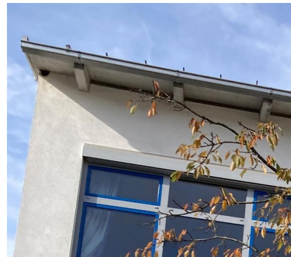
Fassade Mit Bruthöhle unter Überdachung (Abrissgebäude), Foto 16.10.24
