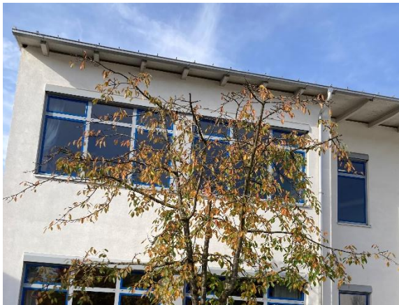
Fassade Mit Bruthöhle (Abrissgebäude), Foto 16.10.24
