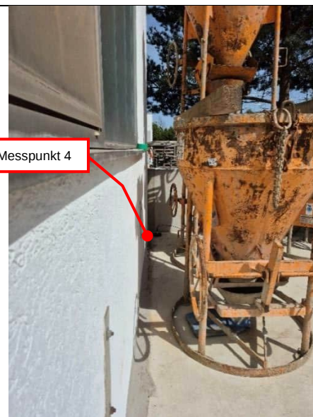
Abbildung 7: Messsensor (MP4) am Fundament des Gebäudes in der Raiffeisenstr. 4; Aufnahme in Richtung Norden
