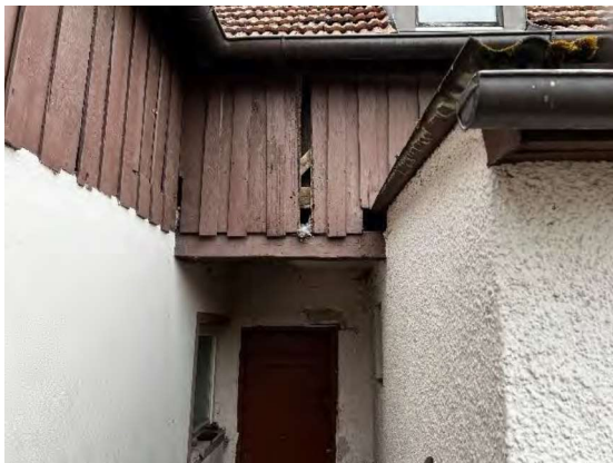
Abbildung 5: Offene Spalten entlang der Fassade, welche zum Dachstuhl führen.
