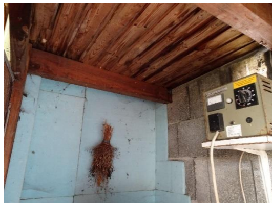
Abbildung 16: westlicher Teil des Gewächshause mit altem Sicherungskasten und Holzdecke (Foto: WipflerPLAN Nov. 2022)
