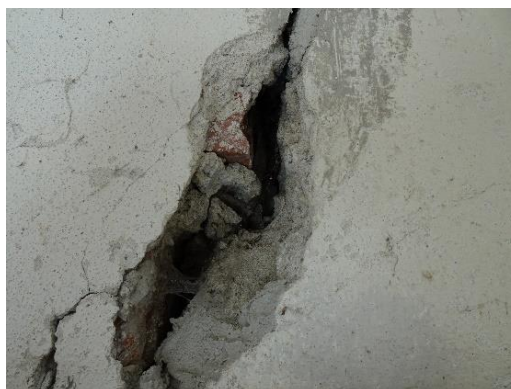
Abbildung 14: Spalt im Mauerwerk im Nebengebäude (Foto: WipflerPLAN Nov. 2022)
